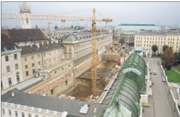
Blick auf die Baugrube in der Studiengebäude, Tiefspeicher und Wechselausstellungshalle entstehen werden
